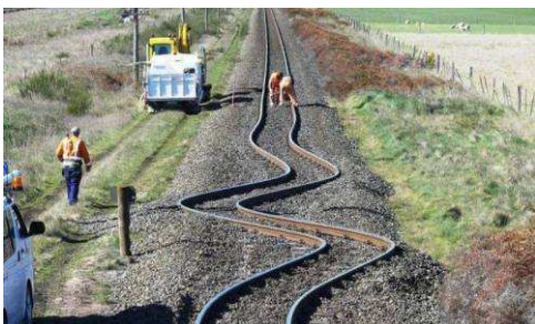
Slika 13.2: Zaradi velike temperaturne razlike se je železniška proga skrivila.
